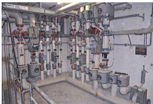
Départ des conduites de chauffage
