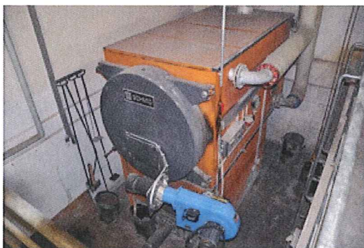
Chaudière datant de 1989
