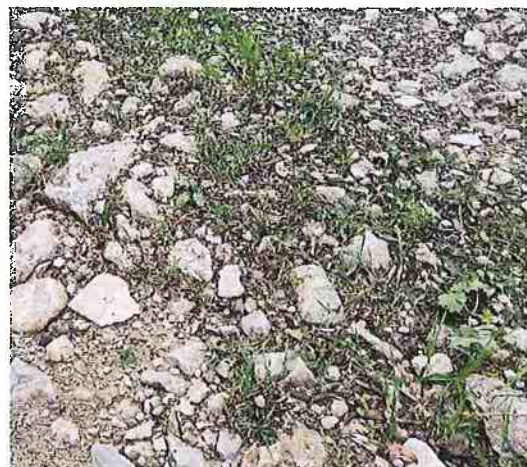
La couche de fermeture est dégradée
