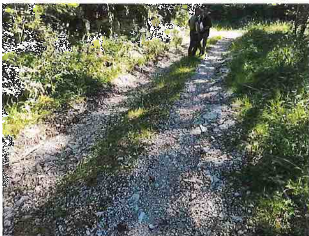
Tronçon de la desserte montrant une déformation du coffre (photos illex 2023)
