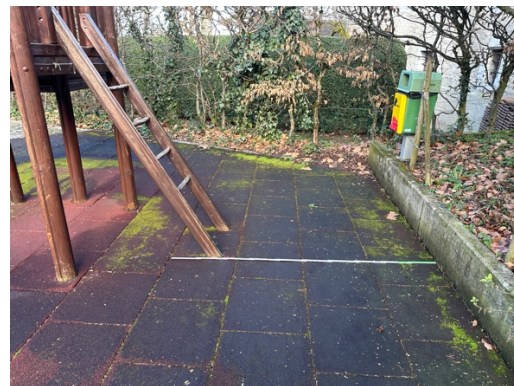
Mousses, végétaux et dépôts divers sur les dalles
