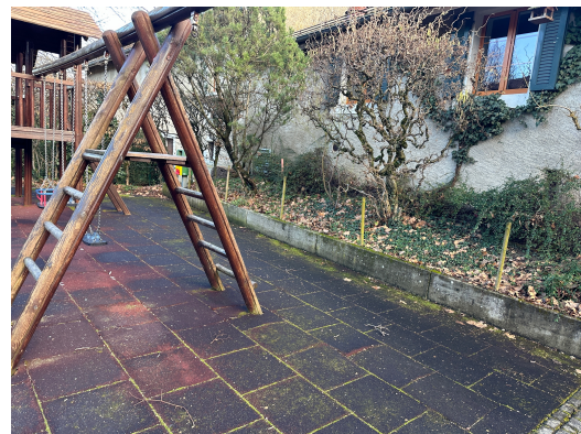
Dépôts sur les joints et dalles de sol
