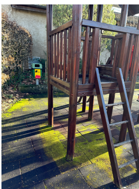
Mousse sur revêtement
