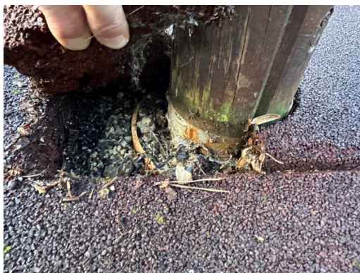
Fondations bétonnées ? Qualité du bois ?
