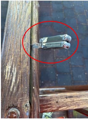
Fissure sur la poutre du portique
