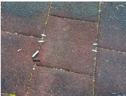
Dalles amortissantes usées, plastiques de liaisons
