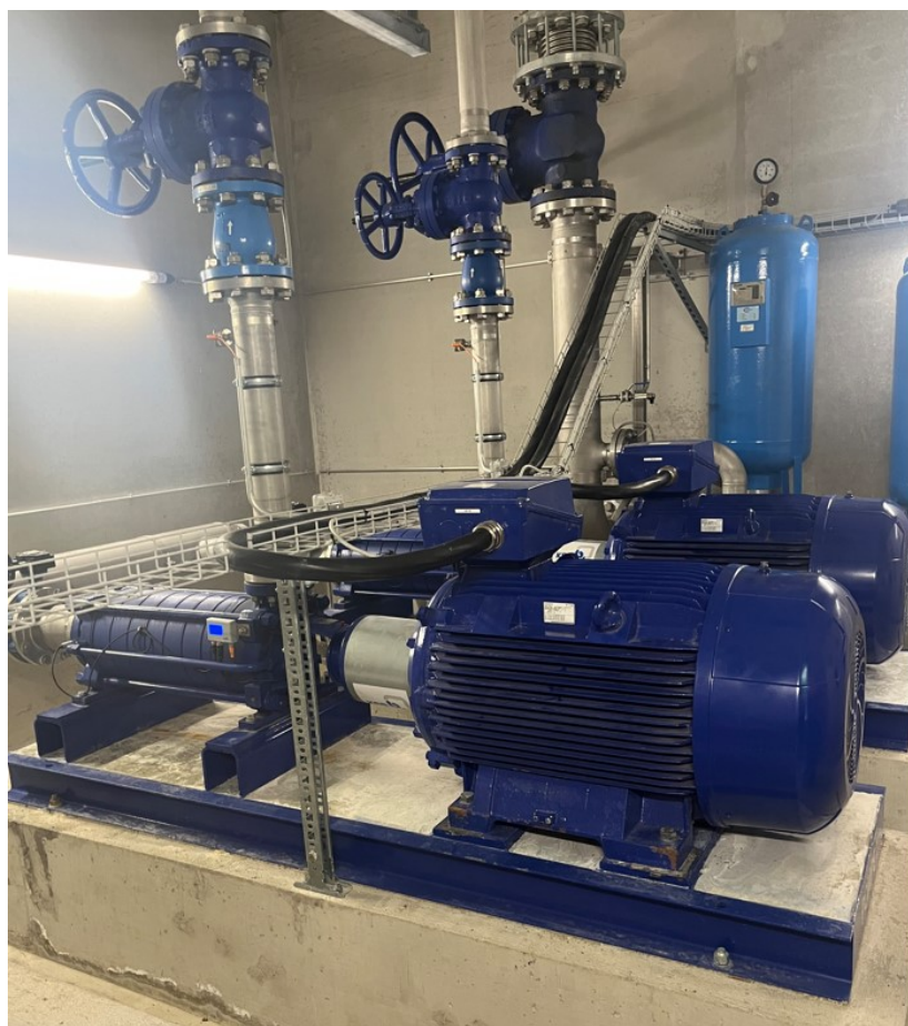
Installation réalisée à Trélex pour le pompage de l'eau potable de la commune de Saint-Cergue.
